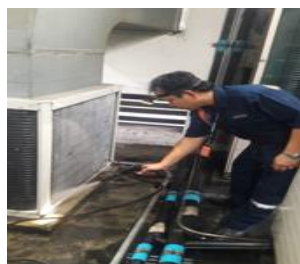
ตรวจสอบและทำความสะอาด คอมเพรสเซอร์และเครื่องปรับอากาศ อย่างสม่ำเสมอ
