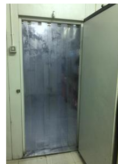
ติดตั้งม่านพลาสติกที่ห้อง ทำความเย็นเพื่อป้องกัน การสูญเสียความเย็น ขณะเข้าออก
