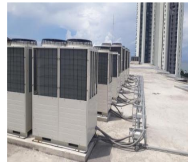
ระบบปรับอากาศใช้ระบบ Inverter ประหยัดพลังงาน
